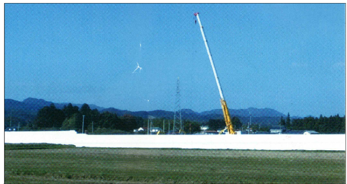
建設中の放射能に汚染された廃棄物の仮置き場(目隠した現場)
